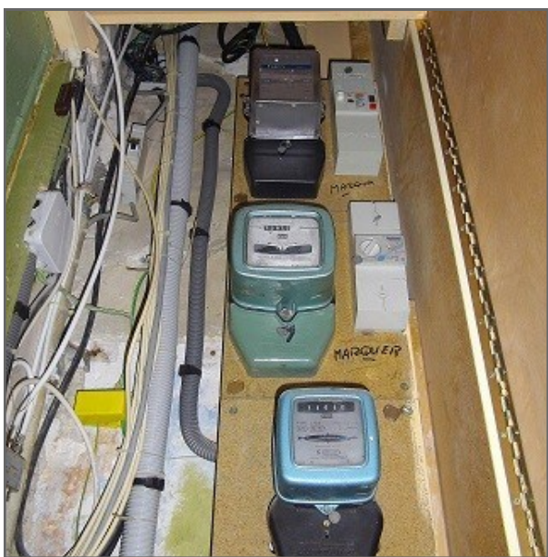
Compteurs électriques (photo Lassarre)
